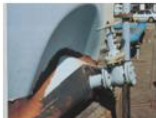
図2. 座屈した水タンクの詳細
